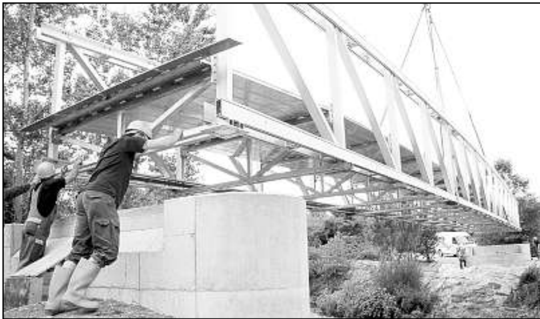
La passerelle n'a aucune pile intermédiaire, pour ne pas gêner l'écoulement de l'eau. Photo Q.D.
